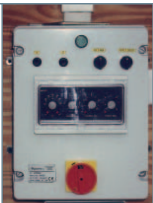
quadro elettrico motori
